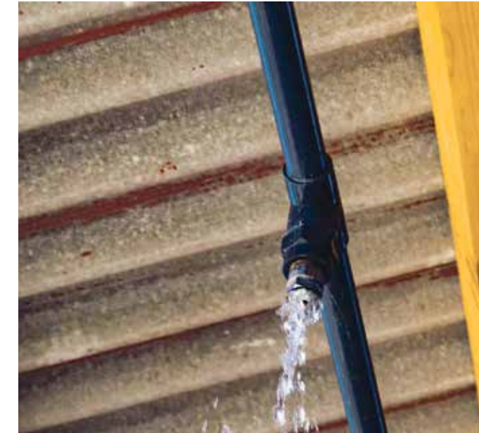
Wasserzufuhr von oben aus einem Tropfschlauch
