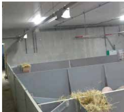
Automatische Ausbringung mittels Rohrkettenförderung. Im Bild eine Anlage der Fa. Ibo.
